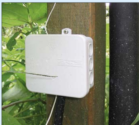
Bild 2: Ein Holzpfehl dient als Ständer der Angelrute und nimmt die Verteilerdose zum Anschluss von Antenne, Radials und Speiseleitung auf.
