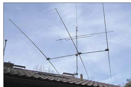
Bild 17: Aufgebaute Antenne 2 m über Dach
